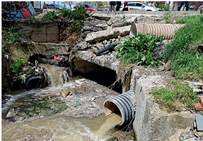
Abwassereinleitung in Prishtina
