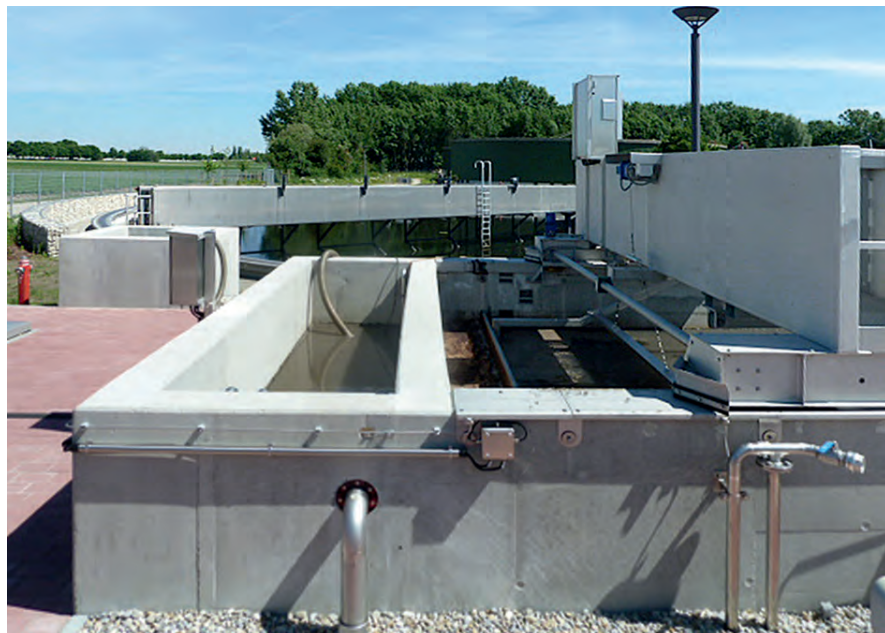
Im Vordergrund Ablauf Vorklärbecken, im Hintergrund Nachklärbecken
